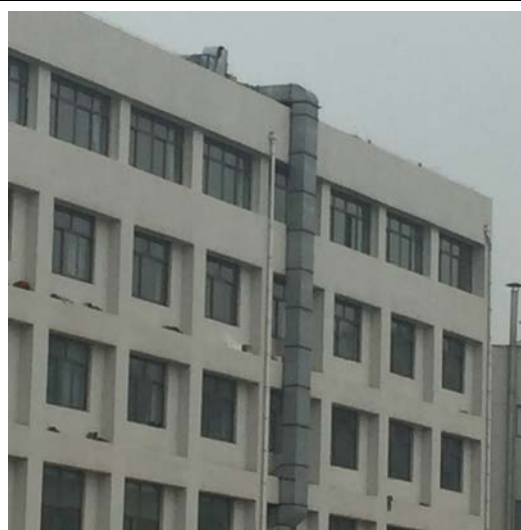
图 3-2 食堂油烟排气筒
